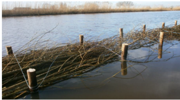
Figuur 11. Vissenbos met een palenrij met onderlinge afstand van 1 meter. IJzerdraad verbindt de palen zigzag aan elkaar, waardoor een stevige constructie ontstaat en de takken bijeen worden gehouden.
