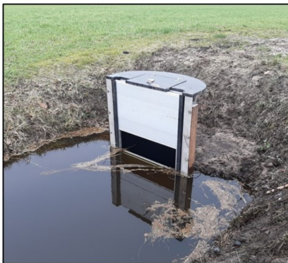
Figuur 1: Voorbeeld van geplaatste stuwput.
