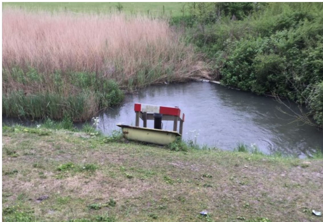
Figuur 3: Uitstroom duiker MAI met afgekalfde oever door hoge stroomsnelheid.
