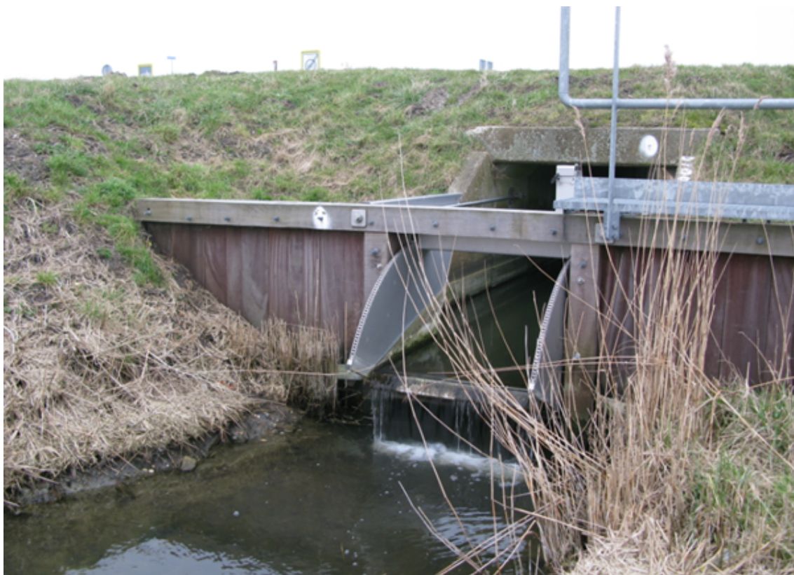
Figuur 3: Stuw Helmhoogte (02877ST) waarvan de klep wordt verbreed.
