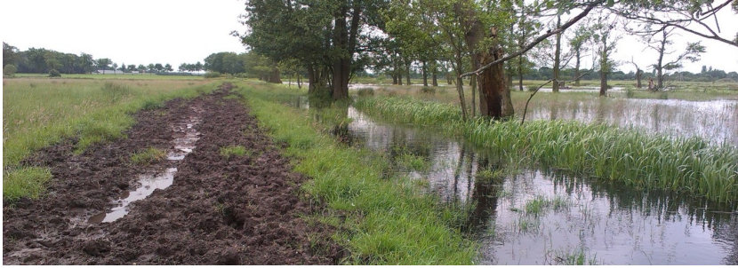
Waterkering rond retentiegebied Roonboom, schade door vertrapping, mei 2014
