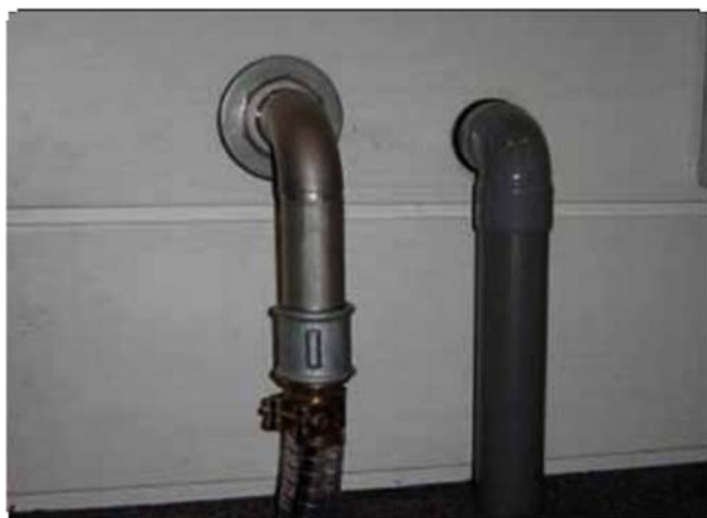
Wanddoorvoer (links) en ontluuchtingsleiding
