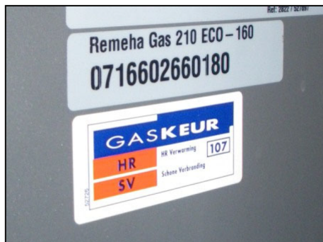
Afb. 9 CV-ketel met HR keur (HR107)
