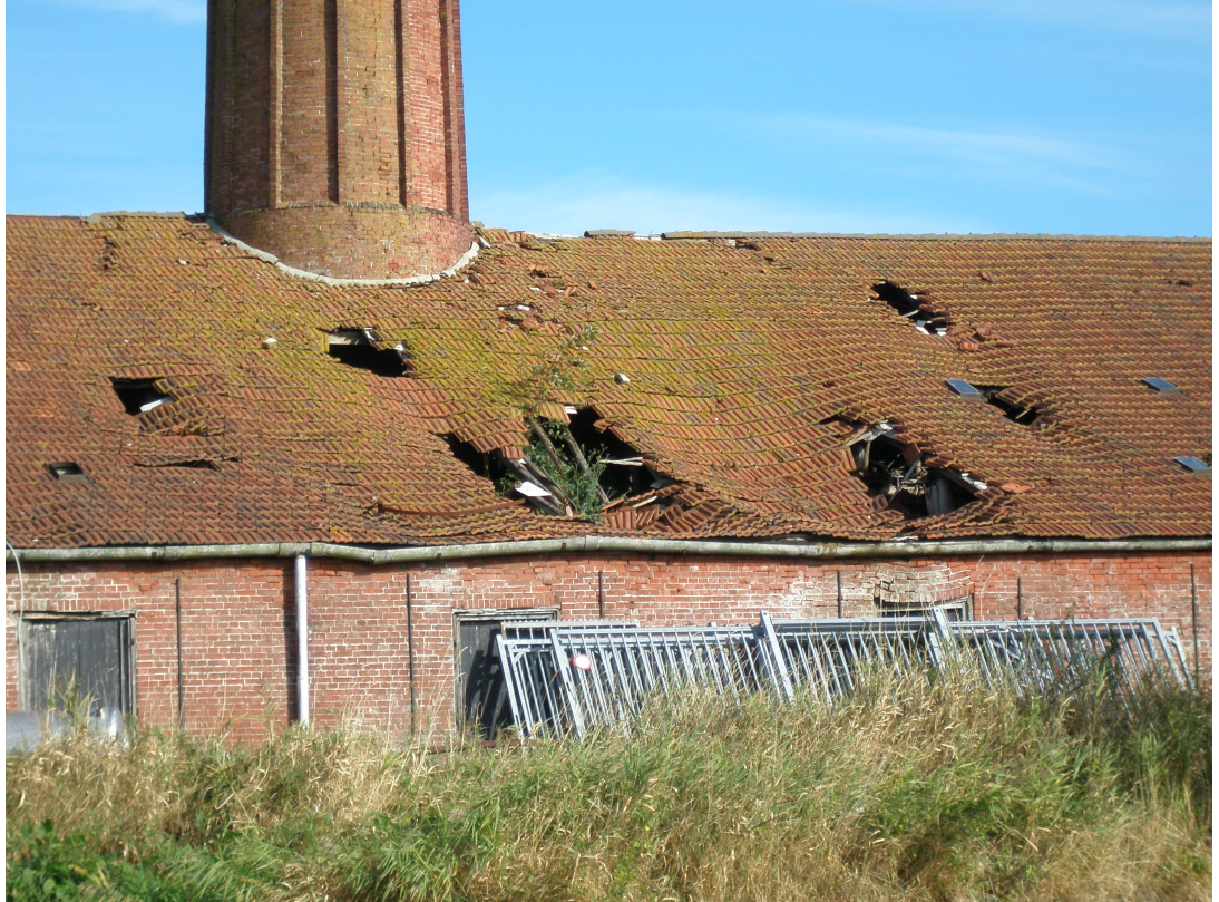
Restauratieachterstand en leegstand; steenfabriek Oostrum
