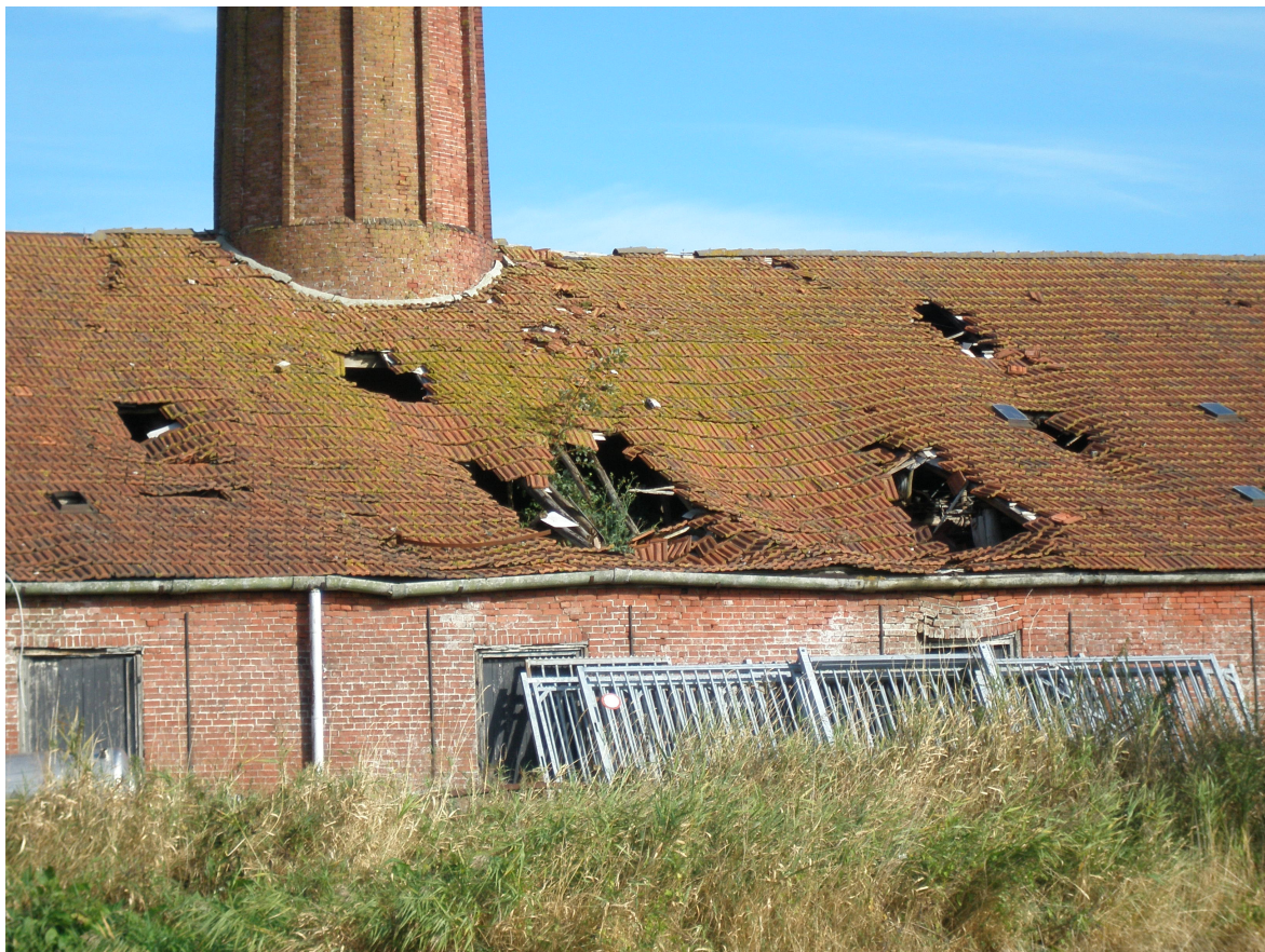
Restauratieachterstand en leegstand; steenfabriek Oostrum
