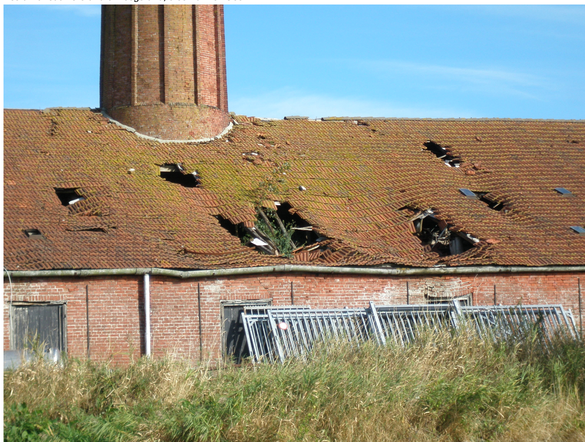
Restauratieachterstand en leegstand; steenfabriek Oostrum
