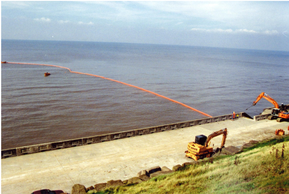
Foto 5.5 Een drijvende kabel (bron: Metoc)
