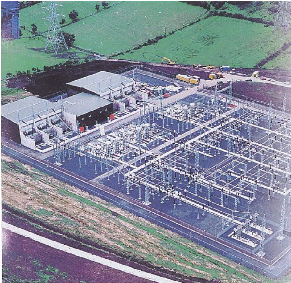
Figuur 4.5 Voorbeeld van een convertorstation
