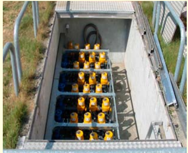
Foto 4: Distributieput grondwatersanering Uden
