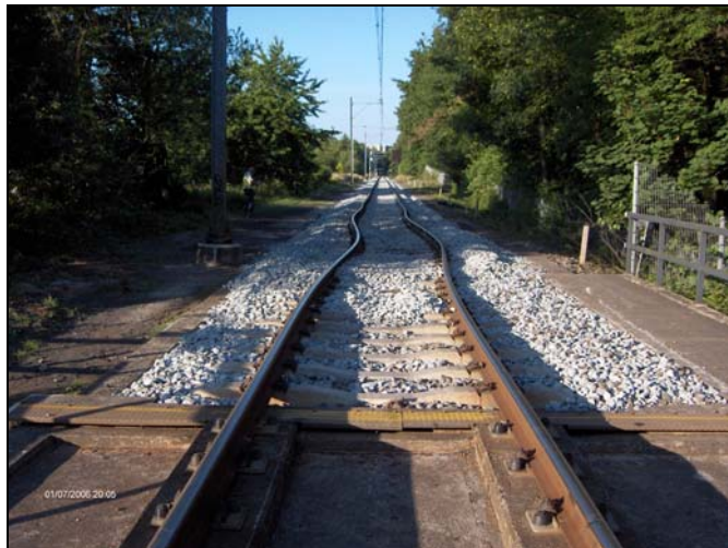
Afb.1: Slingers in het spoor ontstaan doordat spanningen in het spoor, veroorzaakt door temperatuurverhoging, zich een uitweg zoeken door zijdelings uit te knikken (spoorstaafverlenging).
