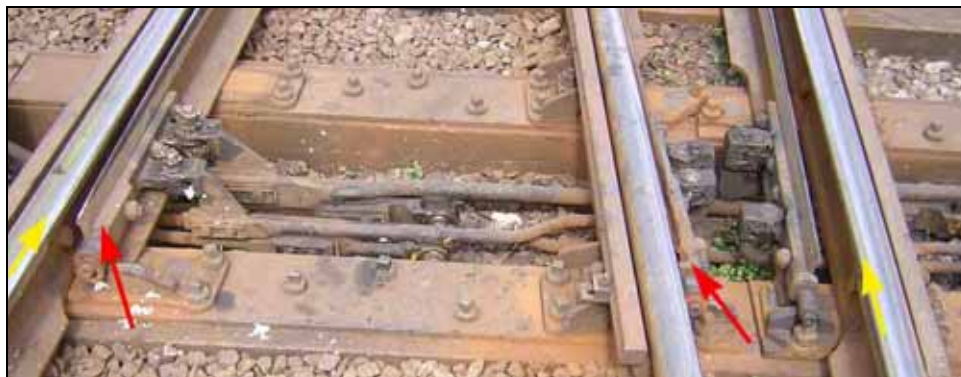
Afbeelding 9: Wissel 63B in de stand aangetroffen direct na de ontsporing. Met gele pijlen is de rijrichting aangegeven en over welke spoorstaven de trein kwam aanrijden. De rode pijl links wijst naar de linker buitentong (engels wissel) die openstaat. Deze is met een stang verbonden met de linker binnentong (rechter rode pijl), die ook openstaat.
