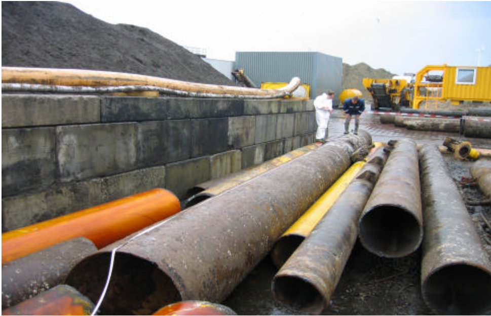
Foto 16: besmet onderdeel van gaswinningsplatform
