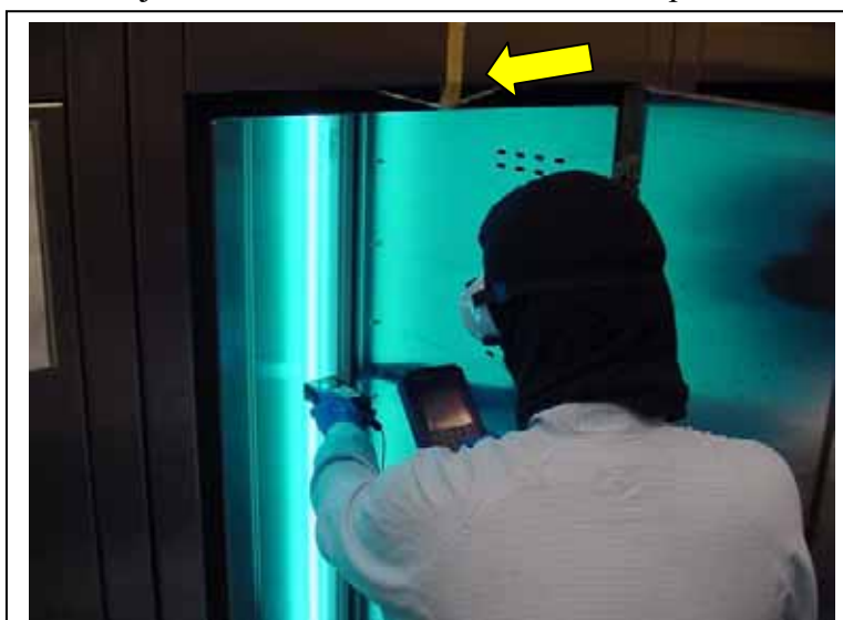
Figuur 31 UV-metingen in een medische droogkast met 254nm UVC lucht- en oppervlaktedesinfectie. Let op de met tape “gefopete” interlock schakelaar (zie pijl), die normaal gesproken de UV-lampen dooft bij opening van de deur. Oog- en huidbescherming is absoluut noodzakelijk bij dit soort werkzaamheden. Onbeschermd is hier binnen enkele minuten de blootstellingslimiet flink overschreden (“gevoel van zand in de ogen”).
