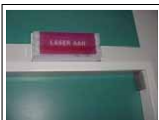
Fig. 45c Lichtbak met signalering "laser aan" bij de toegang tot een laser-opstelling.
