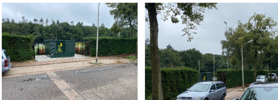
Figuur 11 Transformatorhuisje met haag, bij voorbijrijden is deze minder zichtbaar Bron: Richtlijnen voor de plaatsing van transformatorstations, Nijmegen
