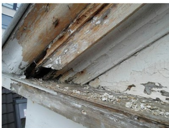
Verval door achterstallig onderhoud
