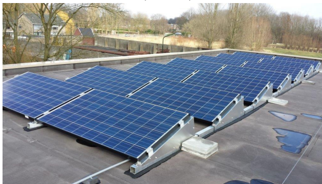
Zonnepanelen op dak
