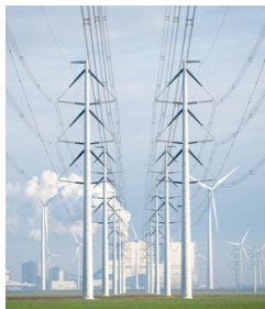
Figuur 6: Wintrackmast. Bron: Rijksinpassingsplan Noord-West 380 kV EOS-VVL
