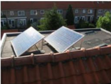
Zonnepanelen op platte daken
