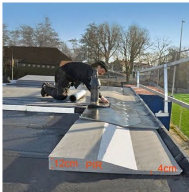
Gootplossing bij extra dikke isolatie op plat dak.
