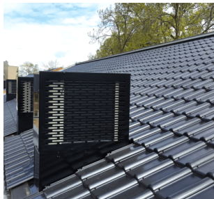
Warmtepompschoorsteen (Bron: www.dhps.nl )
