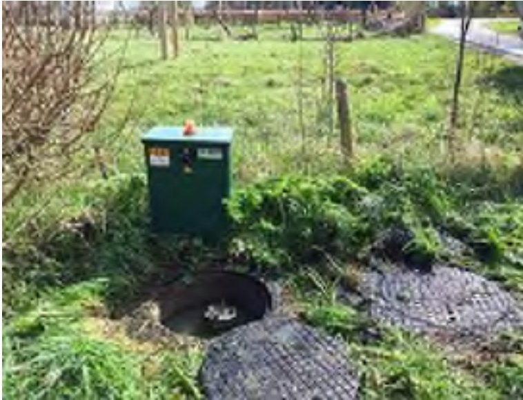
Drukrioolgemaal in het buitengebied
