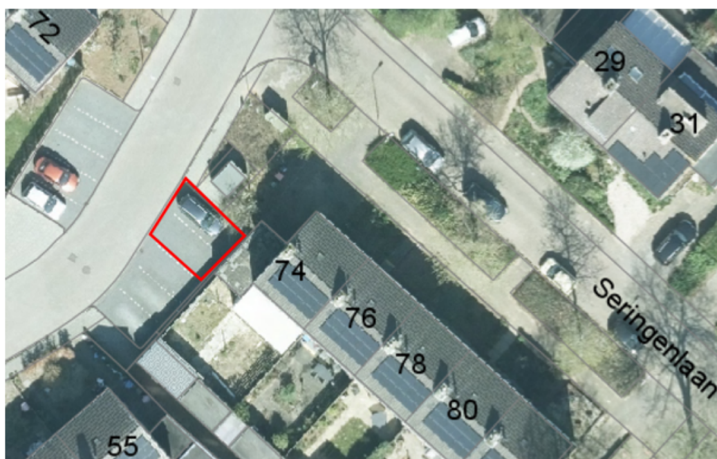
4. Laadpaal ID 67525: Zanderskamp 20F
