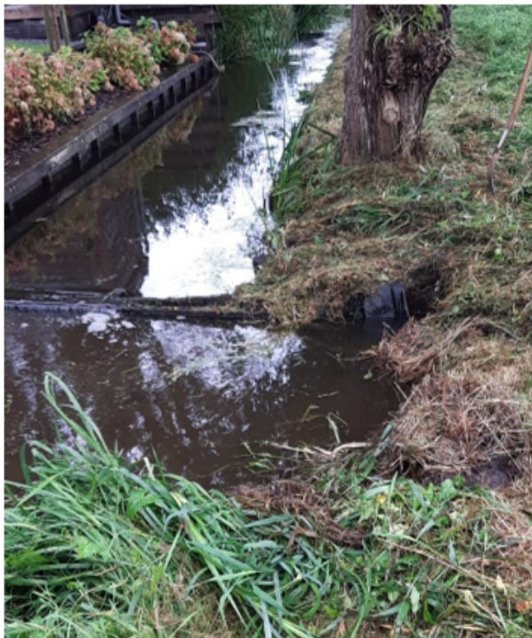
Figuur 3 Niet goed functionerende stuw, verzakt en lek
