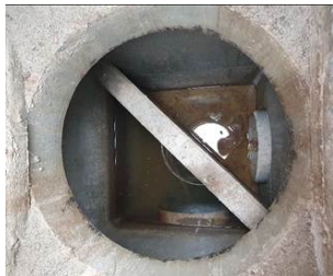
Overstortmuur in rioolput
