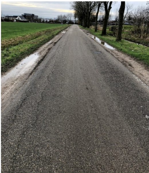
Figuur 18: Typerend wegbeeld. Slechte bermen, scheurvorming en gaten (rechtsboven) deels gecamoufleerd door de slijtlaag
