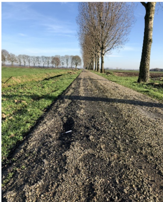
Figuur 19: De verharding is op (lokale weg buitengebied)
