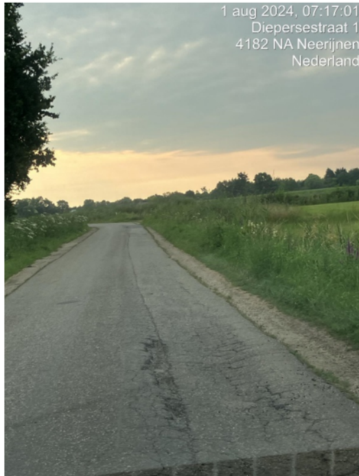
Figuur 13: Natte/ Droogte problematiek leidt tot ongelijke zetting in de weg en gevaarlijke spoorvorming.
