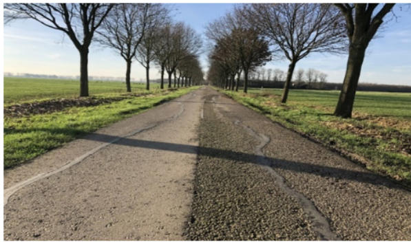
Figuur 17: Lapwerk (met terugkerende schades) in afgeschreven weg
