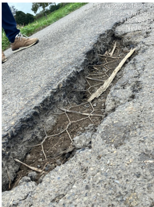
Figuur 12: Ernstige zetting uit de ondergrond leiden ondanks wegdekwapening tot gevaarlijke situaties
