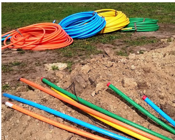
Kabels en leidingen
