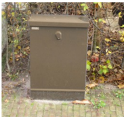
Gecoate elektrakast, geplaatst in hagen
