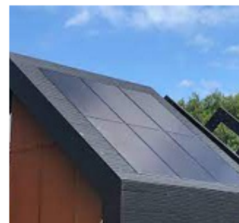
Zonnepanelen geïntegreerd in het dak
