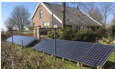
Zonnepanelen achter meidoornhaag (bron: Jack de Vos)
