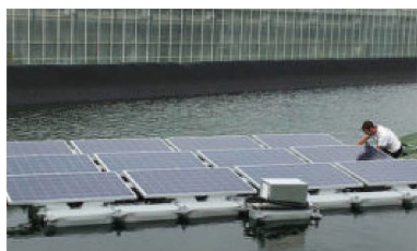
Zon op waterbassin (bron: installatiejournaal.nl)
