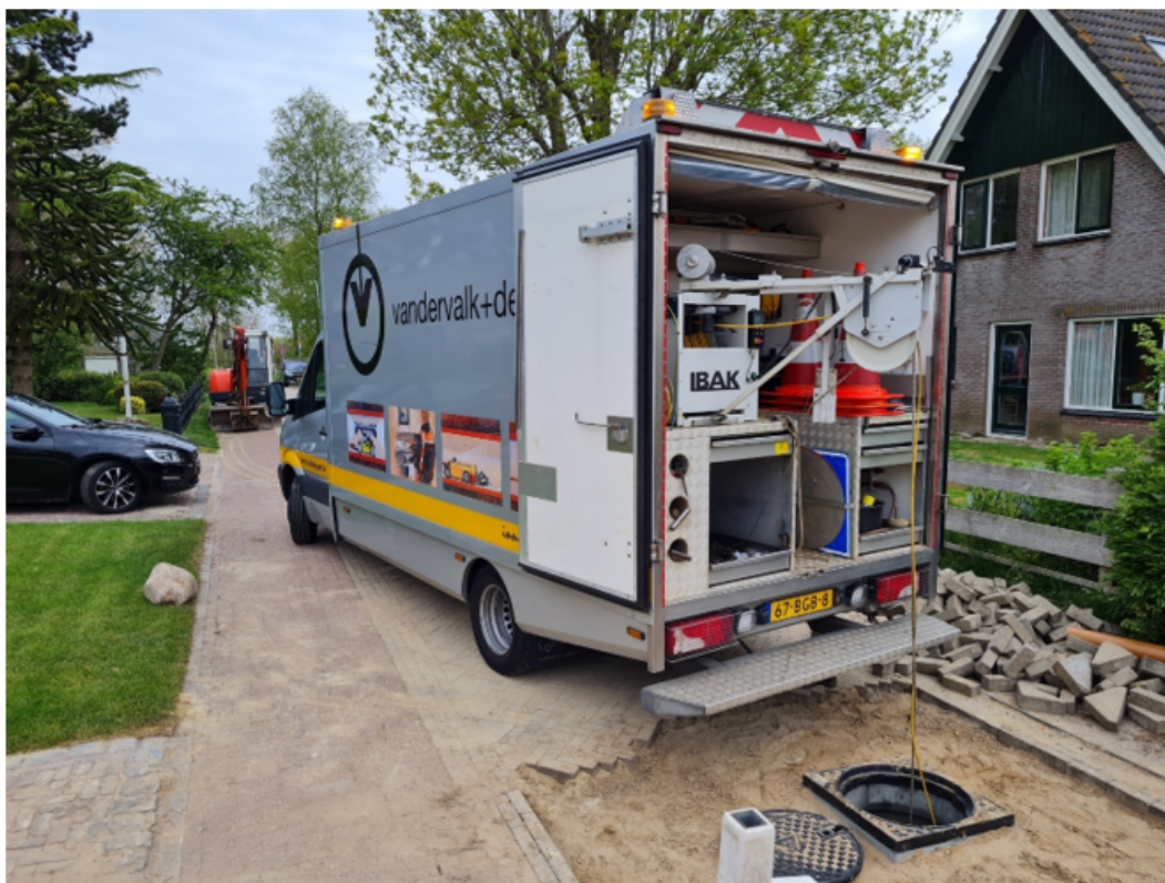
Figuur 8-1: Inspectie hemelwaterriolering in Westlanderlaan
