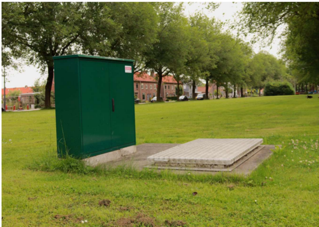
Figuur 7-1: Rioolgemaal Wieringerwerf
