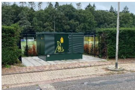
Voorbeeld trafo in de openbare ruimte
