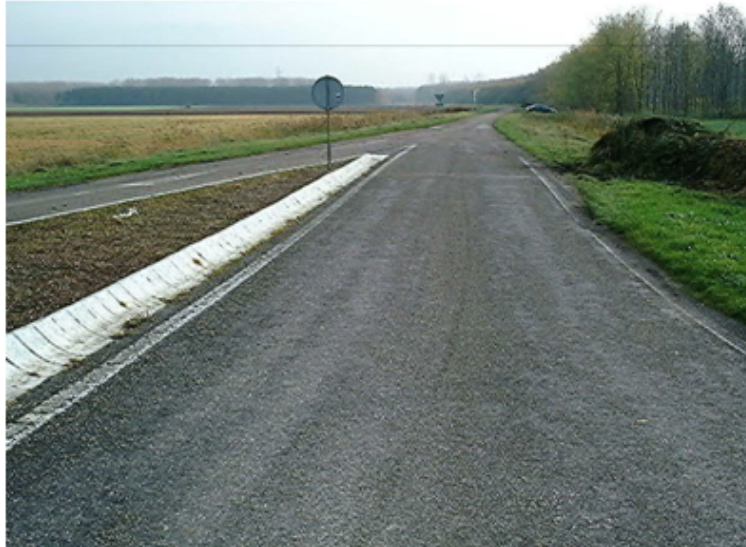
Figuur 2 Schades dwarsonvlakheid en rafeling
