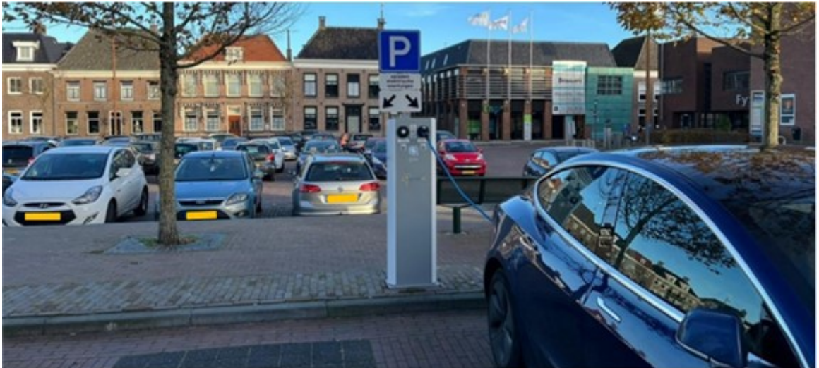
Figuur 16: Gereserveerde parkeerplaats voor opladen elektrische voertuigen.
