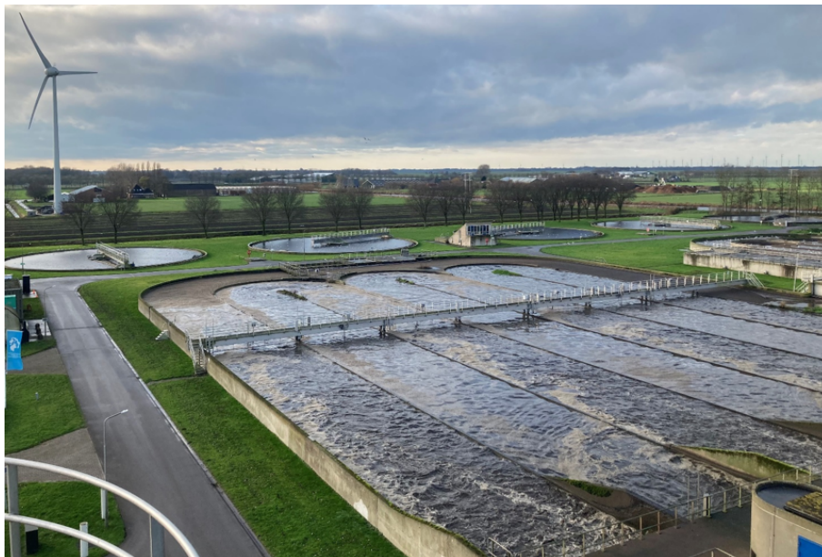
Afbeelding 8: De rioolwaterzuiveringsinstallatie van HHNK in Wervershoof (bron: HHNK, Philippe van de Loo)
