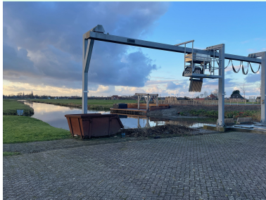
Het gemaal aan de Lutjewallerweg
