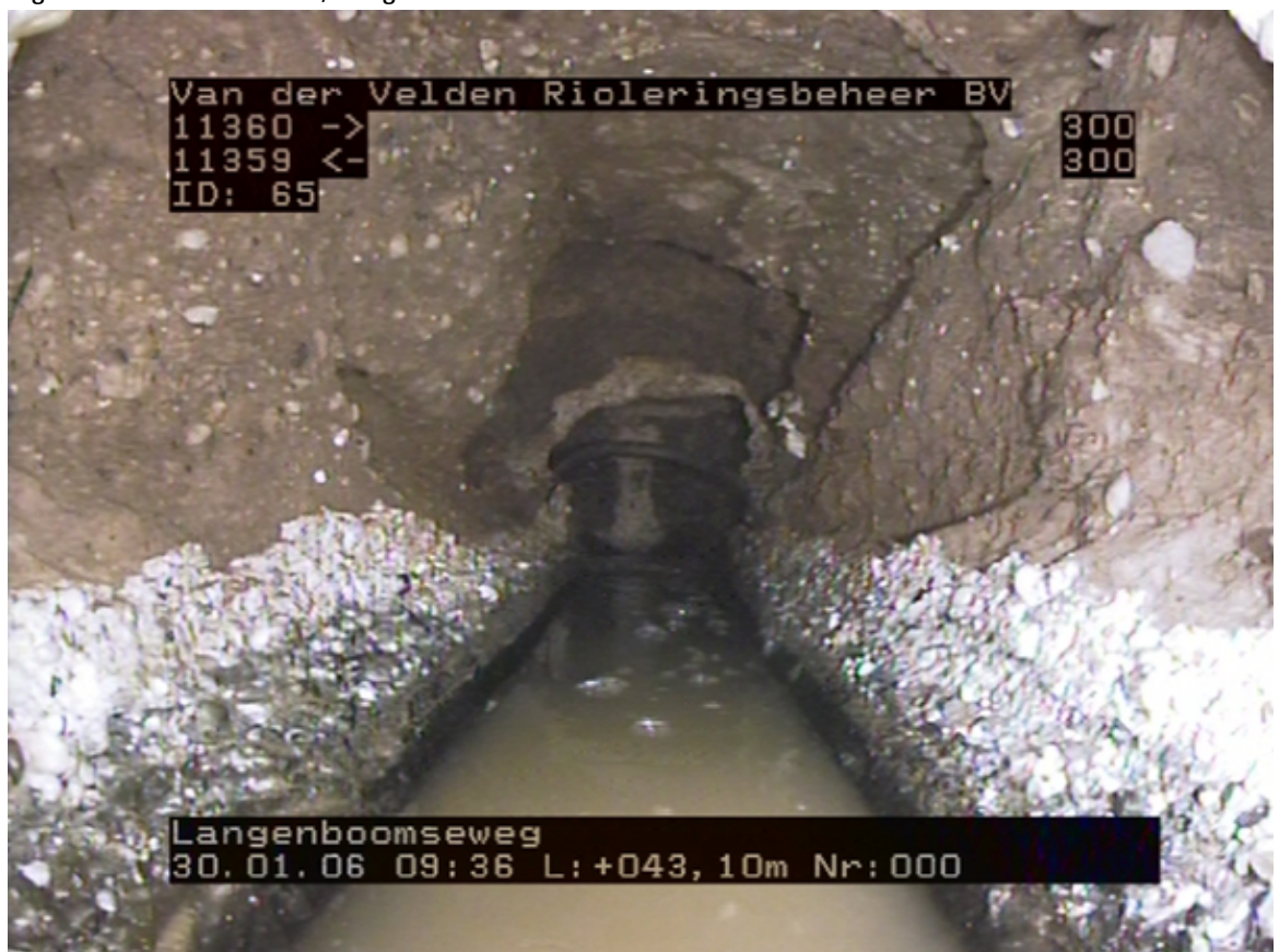
Figuur 8 Rioolbuis in Mill, zo ver aangetast dat de buis weg is.
