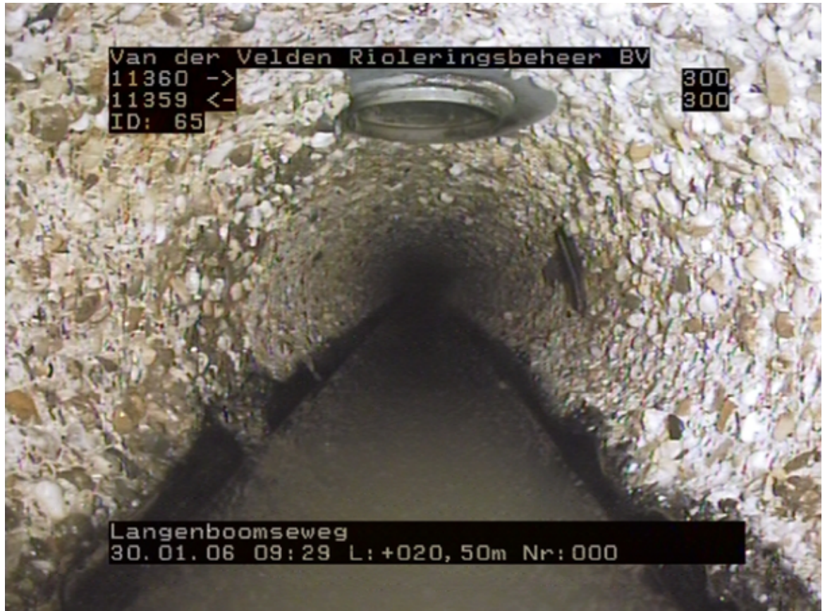
Figuur 7 Rioolbuis in Mill, aangetast door H 2 S
