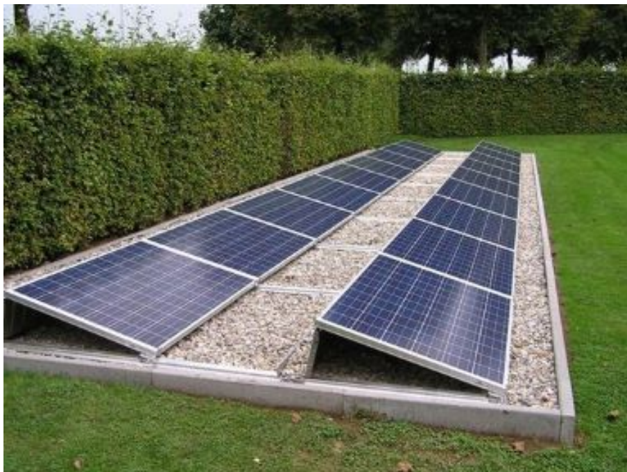
Bron: Zevenbergen zonne-energie
