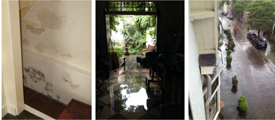
Optrekkend vocht door een hoge grondwaterstand. Foto: bewoner binnenstad
