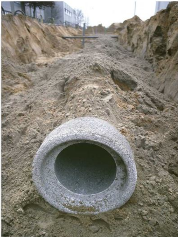
Figuur 2 De aanleg van een rioleringsstelsel heeft veel voeten in de aarde. Bron: GAW | Stichting RIONED
