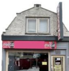
Reclamebakken verstoren het gevelbeeld en verbreken de relatie tussen begane grond en de rest van de gevel.
