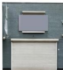
Reclame te hoog gesitueerd en voor het kozijn.
