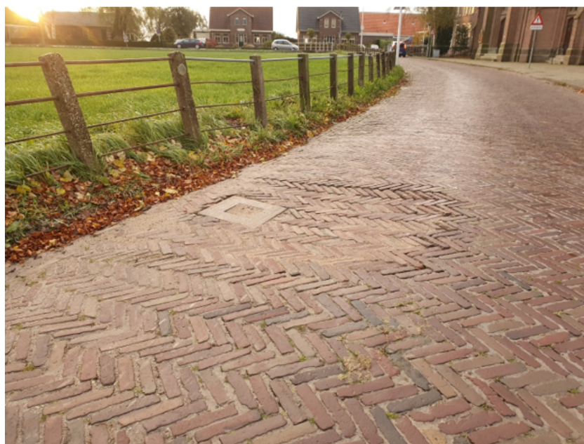
Schade door nutsbedrijf
