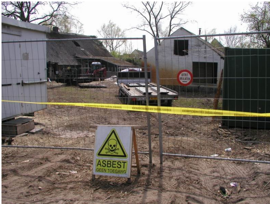
Figuur 17: Afscherming van een asbestverdachte locatie
