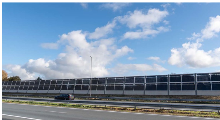
Figuur 3: zonnepanelen in geluidswallen
