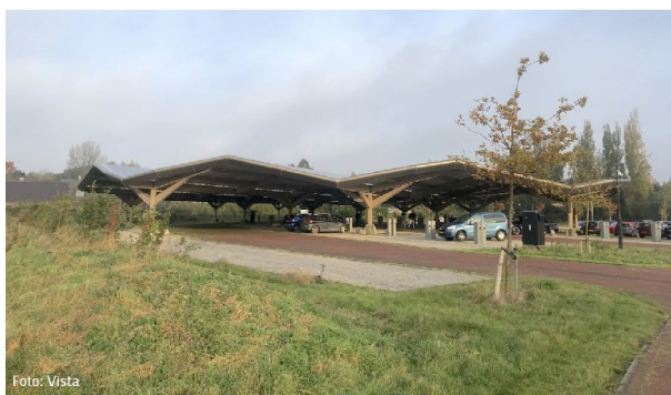
Afbeelding 3.63 Voorbeeld laadplein met zonnepanelen Triodos Bank
