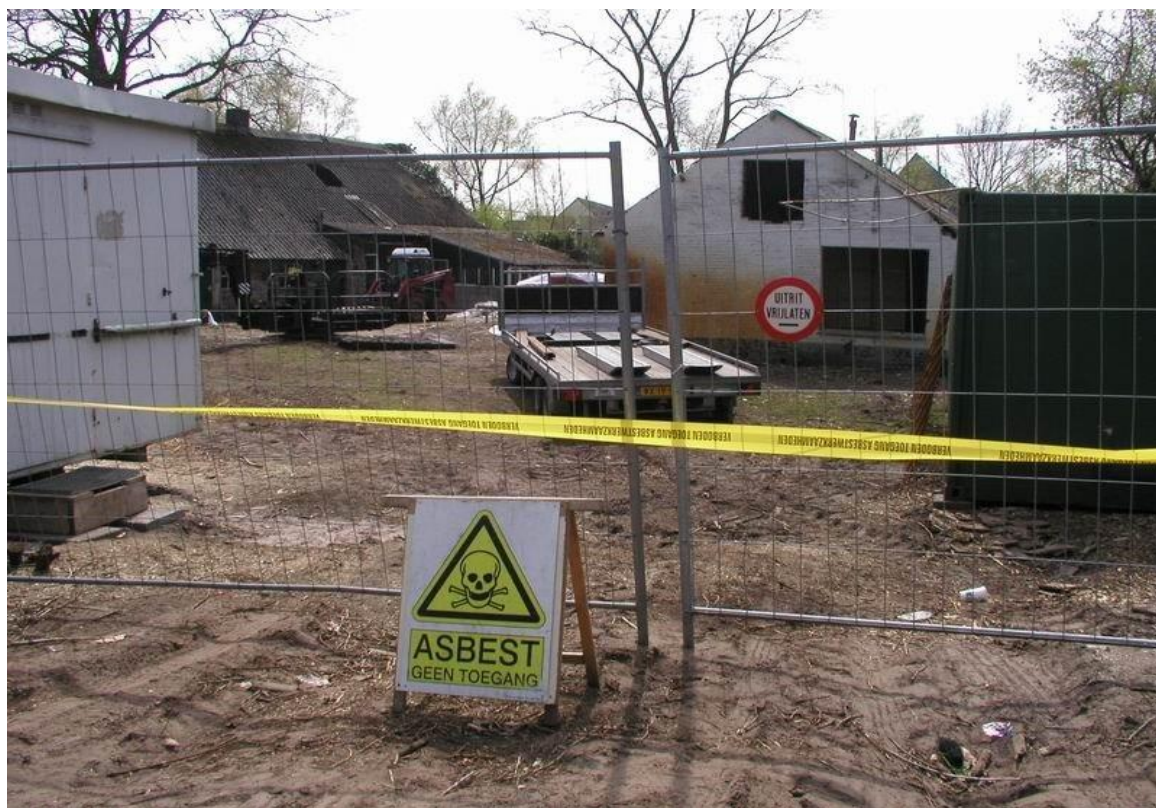
Figuur 17: Afscherming van een asbestverdachte locatie Wanneer is asbestonderzoek verplicht?
