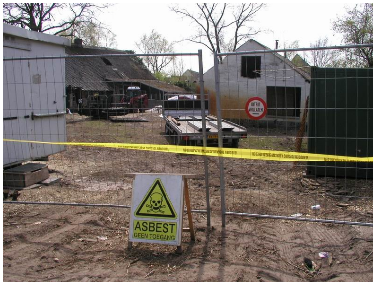
Figuur 17: Afscherming van een asbestverdachte locatie
